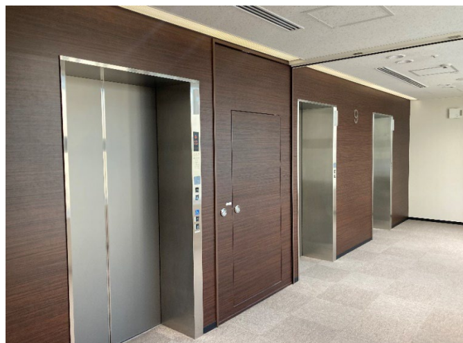
エレベーター
