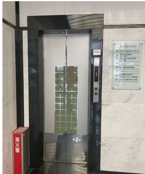
エレベーター
